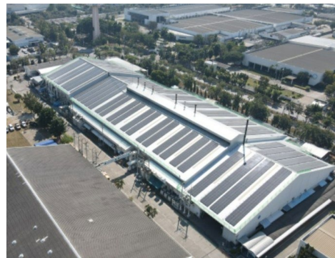
タイ工場に設置された太陽光発電設備
