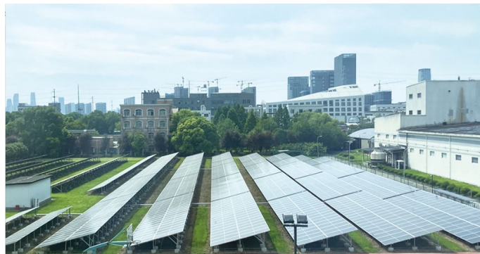
中国工場に設置された太陽光発電設備
