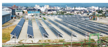
魚津工場に設置された太陽光発電設備
