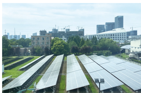
恩希愛(中国)に設置された太陽光発電設備
