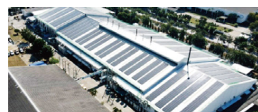
ECT(タイ)に設置された太陽光発電設備
