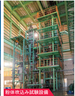
粉体吹込み試験設備
