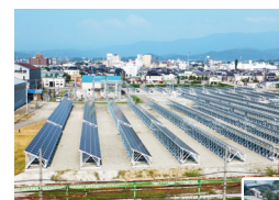
魚津工場に設置された太陽光パネル
