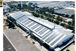
タイの工場に設置された太陽光パネル
