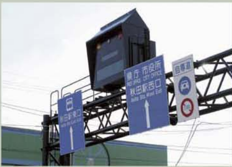
秋田県秋田中央道路建設事務所 (パネクス・プリズム型)
